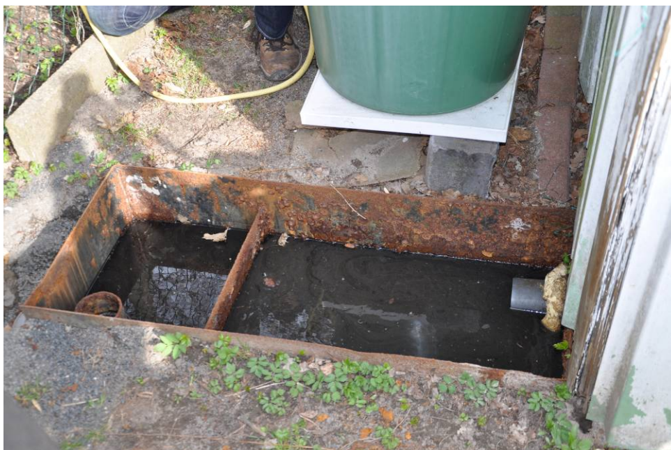
Abbildung 1: Durch Korrosion geschädigte Sammelgrube aus Stahl (Bildquelle: Gürcke)
