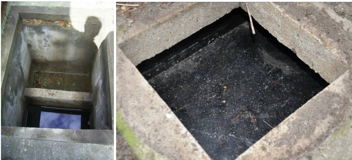
Abbildung 2: links: Zweikammersammelgrube aus Beton /BARJENBRUCH UND WRIEGE-BECHTOLD 2005/, rechts: Einkammersammelgrube aus Beton (Bildquelle: Gürcke)
